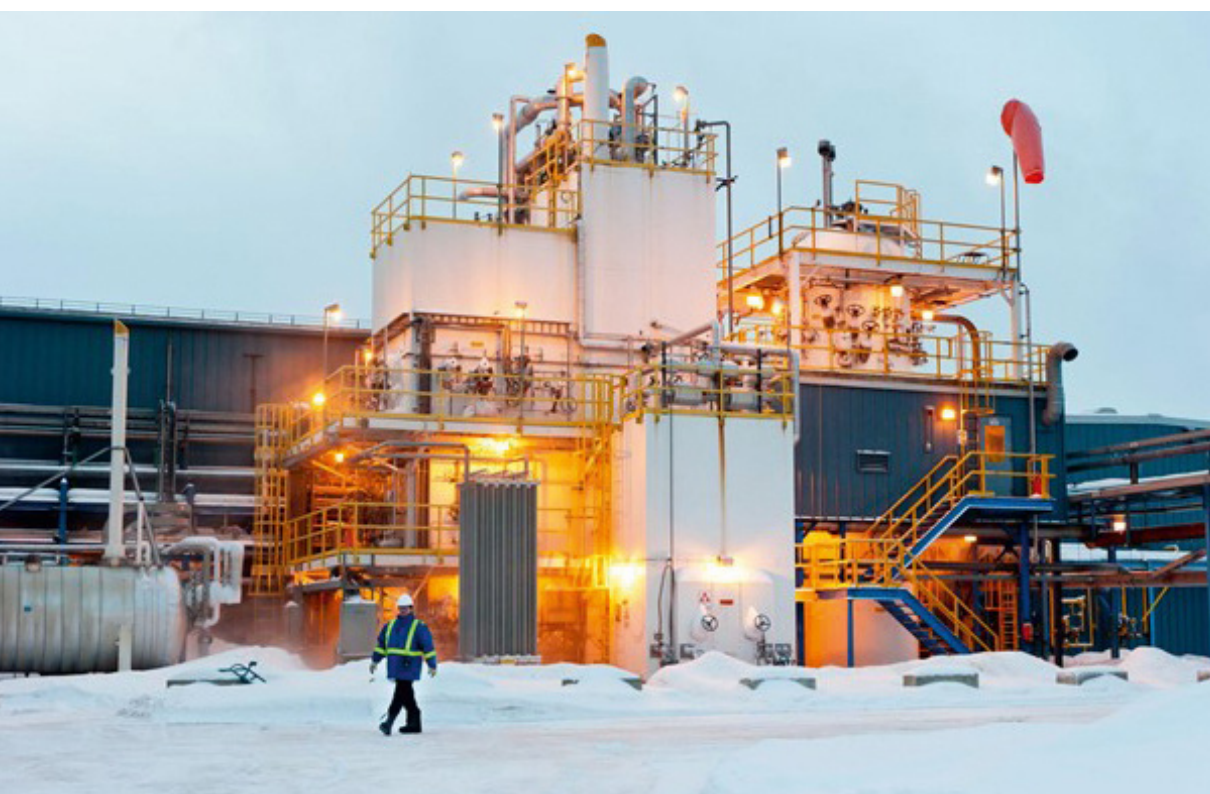
Mit der Anlage in Bécancour in Kanada wurde im Januar 2021 die weltweit größte Proton Exchange Membrane-Elektrolyseanlage mit einer Kapazität von 20 Megawatt in Betrieb genommen.
